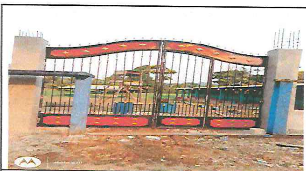
Foto 5: Se observa el porton del establecimiento fue sustituido
